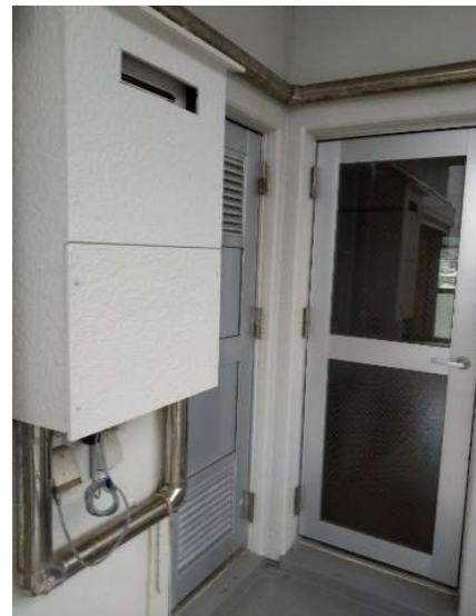
給湯器 収納庫
