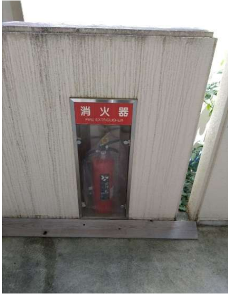
共有スペース：消火器
