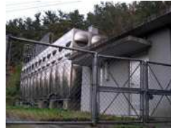
大和ダム浄水場
